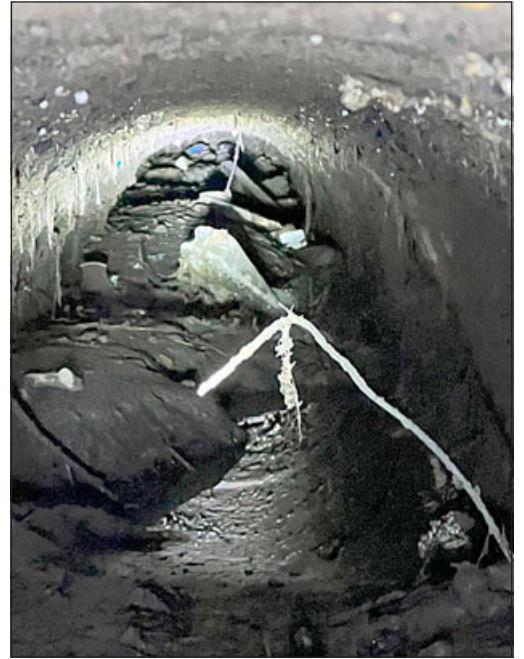
Repletos de basura, escombros y otros elementos, así está el ducto en la alameda O´ Higgins.
