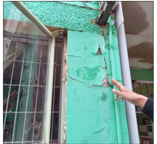
En la imagen se puede apreciar la pintura descascarándose, esta situación también se vive en la parte posterior del jardín.
