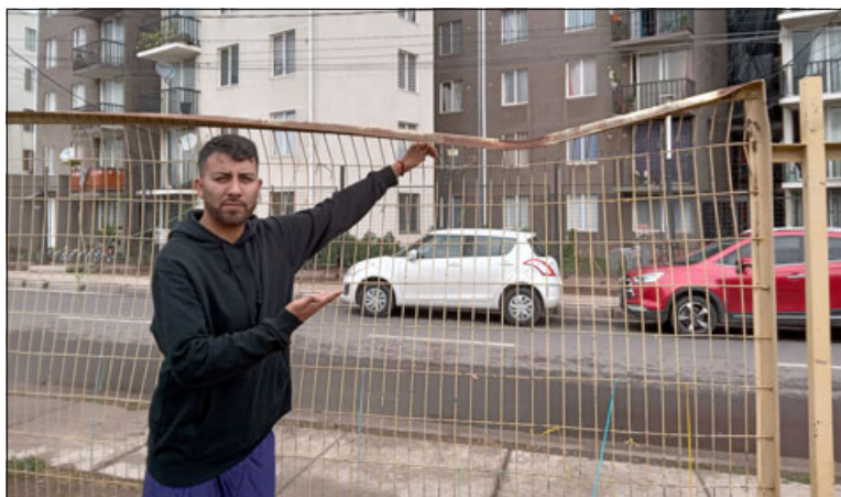
Esta es la reja en mal estado producto de un accidente que hasta el momento no ha sido reparada.
