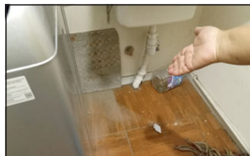
Esta es la calidad de los baños entregados con el departamento, además con filtraciones.
