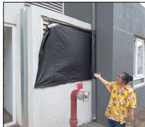
DEPARTAMENTOS COPEVA.- Con nylon tuvo que cubrir la logia porque se estaba pasando toda el agua lluvia.
