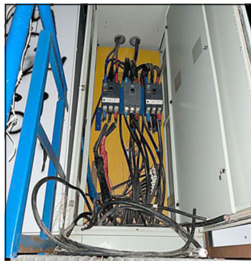
El robo registrado durante la madrugada de ayer en el sondaje Granallas obligó a realizar un corte de emergencia en diversos sectores de Putaendo.
