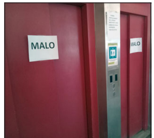
Malos están los dos ascensores instalados en el edificio de la Delegación Presidencial Provincial de San Felipe.
