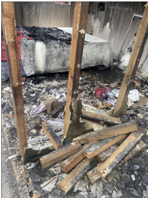
El fuego destruyó la vivienda con todos sus enseres en el interior.
