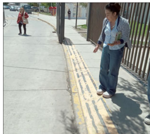
Romina frente donde se cayó por el mal estado del antideslizante.
