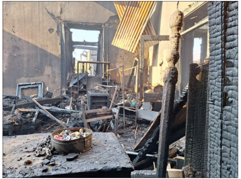
Reducida a cenizas, así quedó la vivienda que se incendió en calle Carlos Condell.
