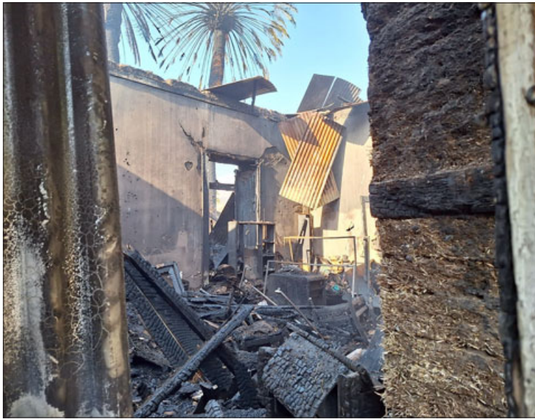
El techo de la casa resultó totalmente quemado.
