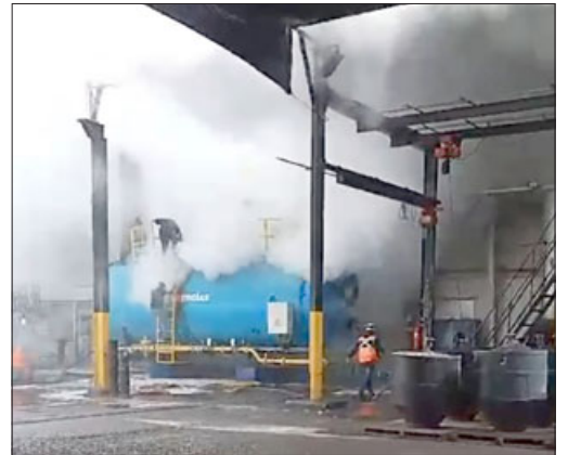
Este es el momento en el que explota la caldera, trabajadores intentan huir del lugar.
